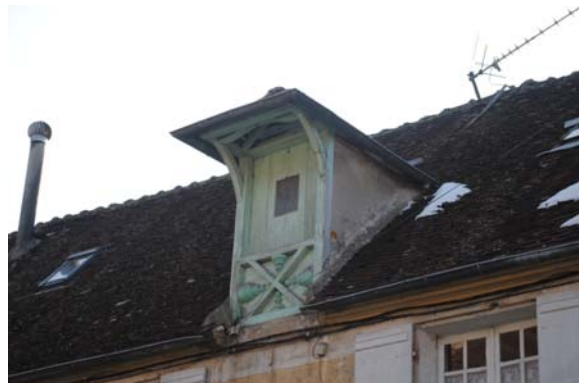
Lucarne à restaurer
